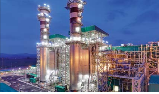
28 Hatay - Erzin 870 MW Doğalgaz Kombine Çevrim Santrali
