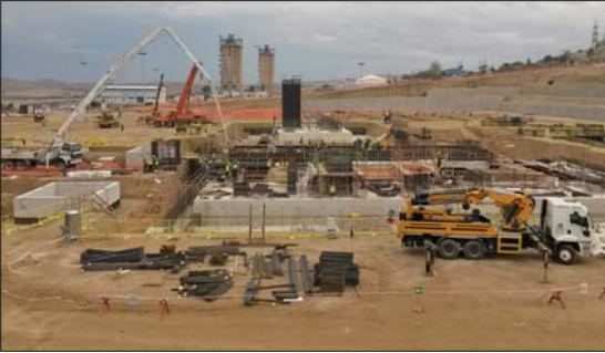
32 840 MW Kırıkkale Doğalgaz Kombine Çevrim Güç Santrali
