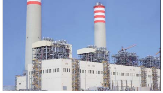
36 Libya - Al-Khalij 4x350 MW Enerji Santrali Projesi
